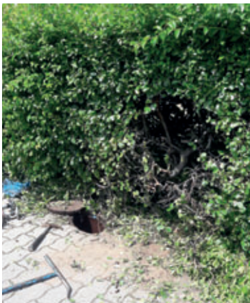
Eine Hecke im Schutzstreifen einer Trinkwasserleitung.
